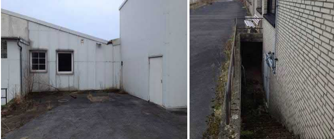
Abbildung 5: Linkes Bild: Bereich des verfüllten Öltanks (KRB 16), Rechtes Bild: Kellerabgang - lt. Plan im Keller 10 x 1.500 l Öltanks, hier war jedoch kein Zugang möglich, so dass über die tatsächliche Existenz dieser Tanks keine Angabe gemacht werden kann (KRB 15)
